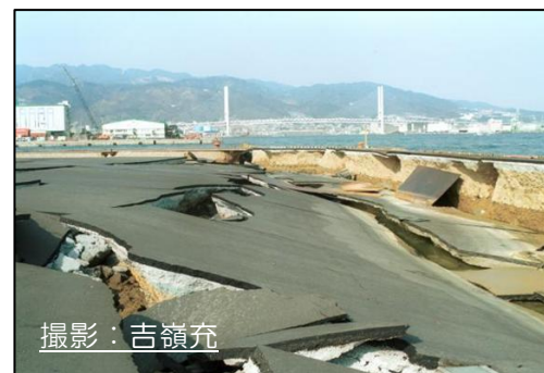
地震時の港湾構造物等の被災
